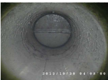
Photos d'une gaine ronde encrassée de 300mm de diamètre
