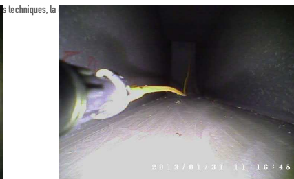
La camera arrière facilite et sécurise le retour du robot.
